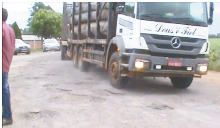
>> Buracos atrapalham o tráfego de veículos na rodovia
