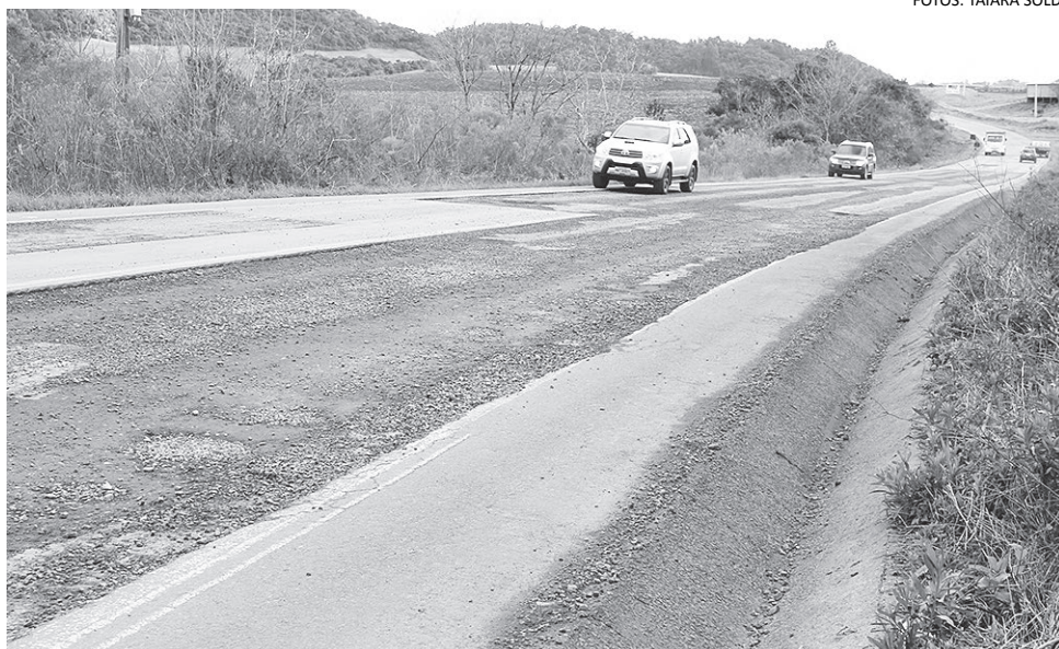
>> Camada antiga de asfalto foi retirada, mas em alguns pontos ainda não foi recolocada
